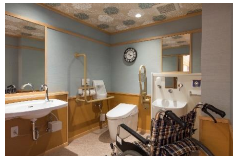
車椅子でも出入りがしやすい 十分な広さ・空間 を確保したトイレへの整備
